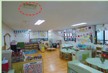
(나) 급기팬 설치
